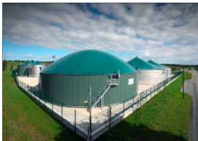
Así, los dos fermentadores de acero inoxidable de Aurora, con una capacidad de 3.573 metros cúbicos, serán alimentados diariamente con 100 toneladas de residuos orgánicos.
