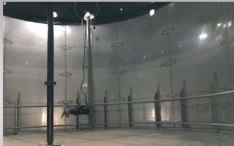
Los recipientes previos de almacenaje de acero inoxidable cuentan con suelos de acero inoxidable
